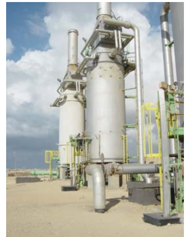
Heater at Zueitina Terminal
